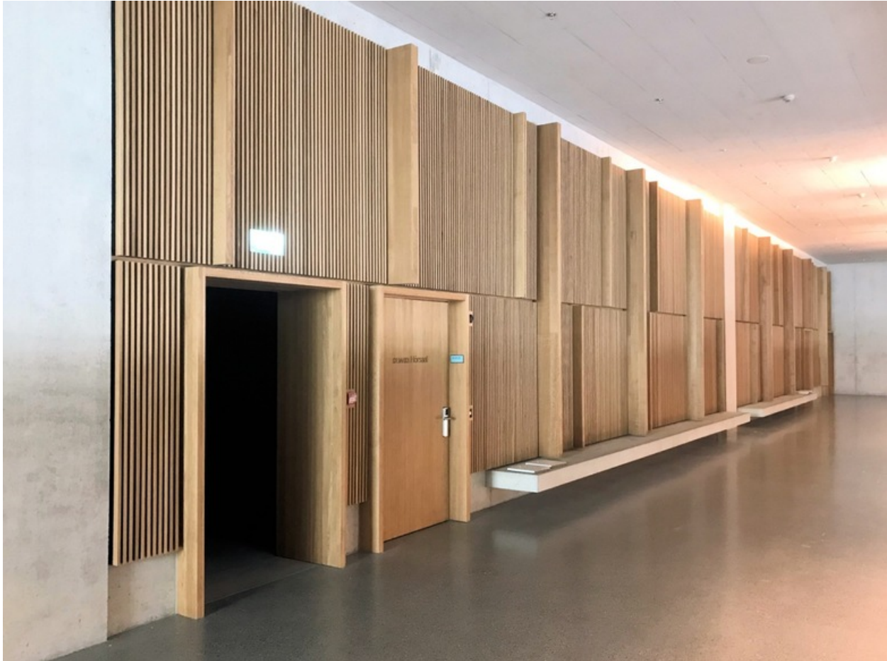
In die Lamellen aus Eiche sind auch die Öffnungen der Überströmelemente von Kiefer Luft- und Klimatechnik ( https://german-architects.com/de/kiefer-luft-und-kimatechnik-stuttgart ) eingebunden. (Foto Zeljko Gataric © FHNW Campus Muttenz)
