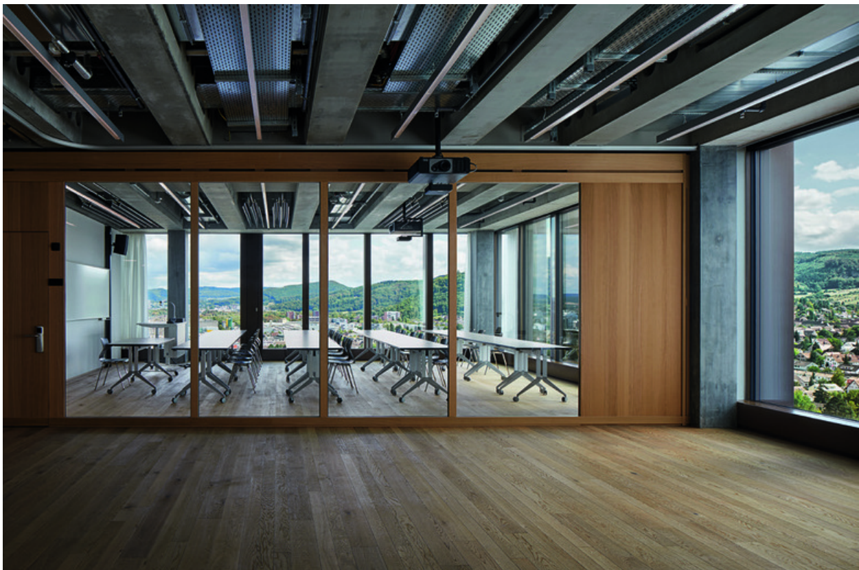
Alle Zuluft-Leitungen sind sichtbar in den Rippen der Betonrippendecken eingelassen. (Foto: Tom Bisig)
